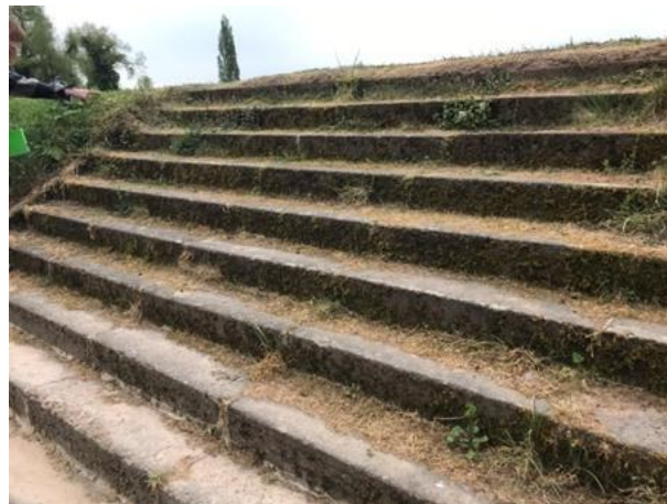
Steile und schadhafte Treppe am Alleerassen
